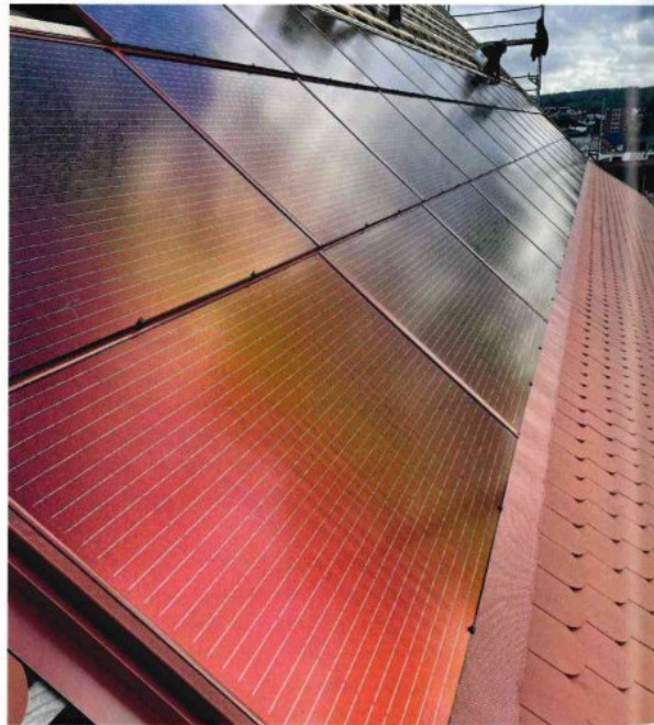
Nahaufnahme der roten PV-Module.
